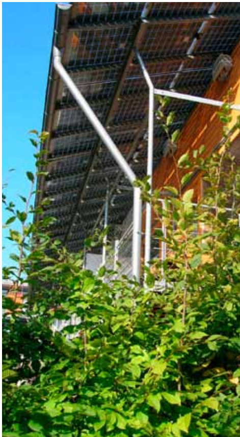
Solceller på taket till bostadshus
